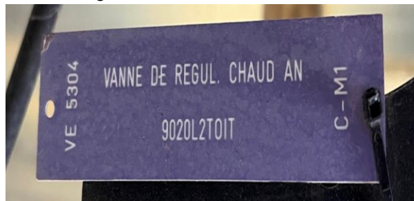
Figure 116 : Étiquette vanne Chauffage
