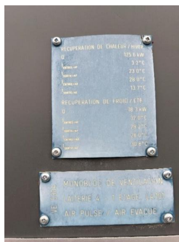
Figure 118 : Récupération de chaleur
