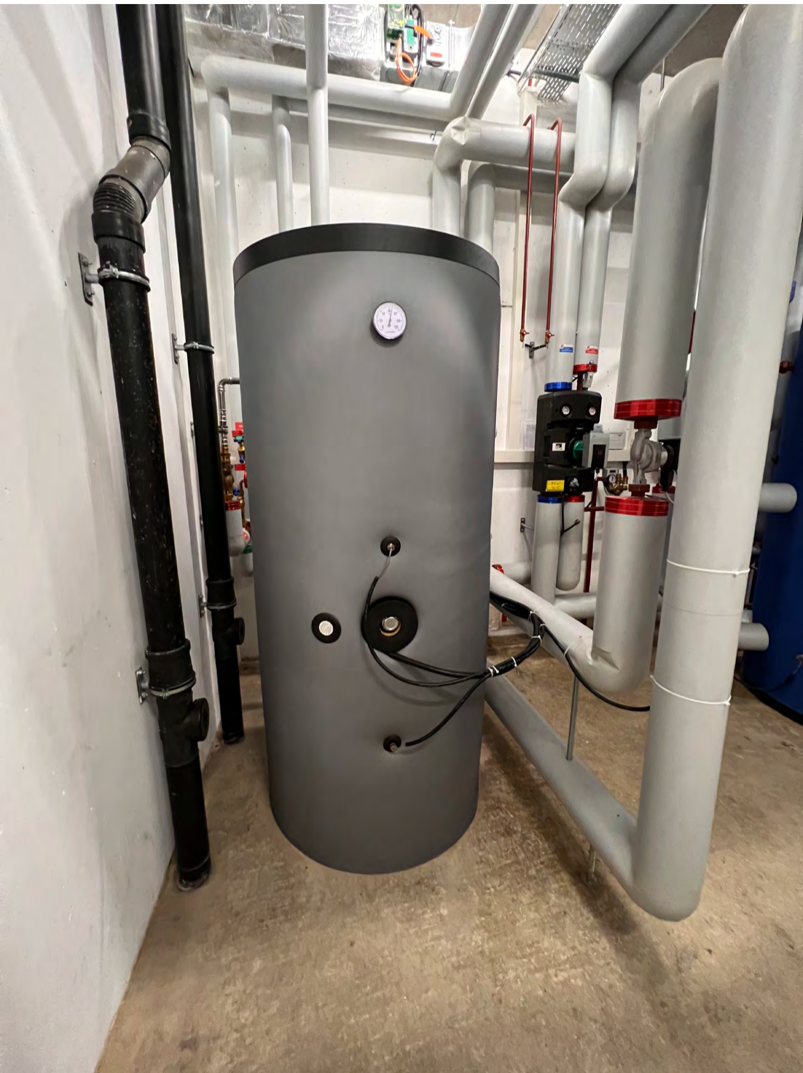
Exemple d'un chauffe-eau existant
